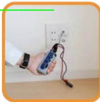
トーンプローブセットによる 電話配線の確認
