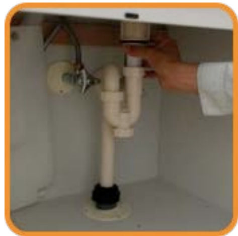
キッチン配水管の漏水確認
